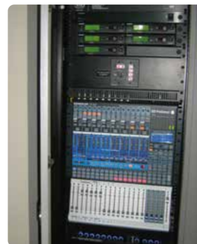
AV rack with PreSonus mixing desk
